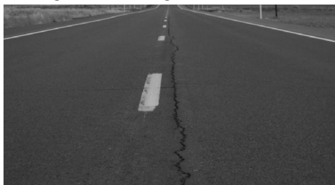
Figura 2: Trincas longitudinais e transversais
