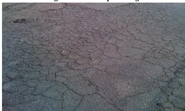
Figura 1: Trincas por Fadiga
