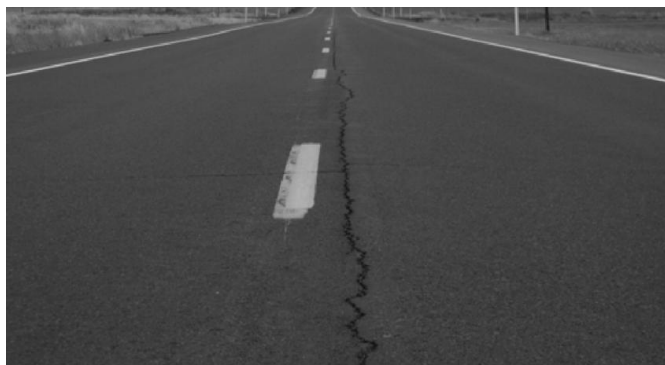
Figura 2: Trincas longitudinais e transversais
