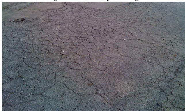
Figura 1: Trincas por Fadiga
