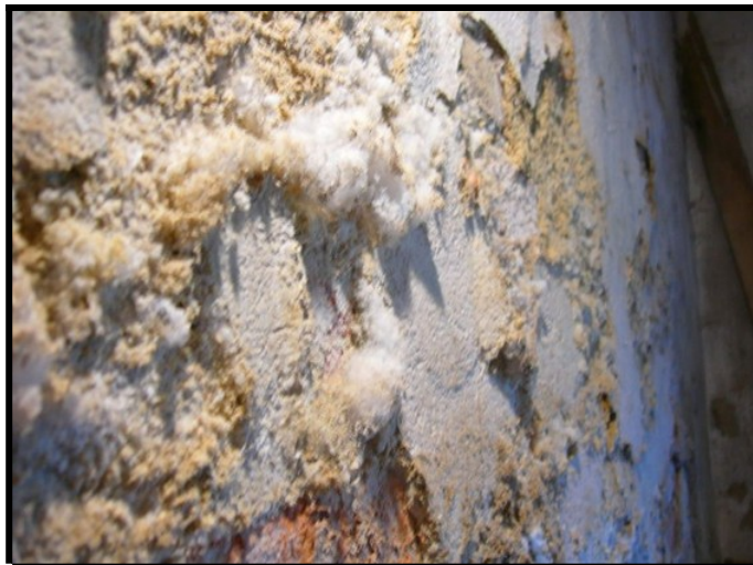
Figura 5 - Criptoflorescência em parede.
