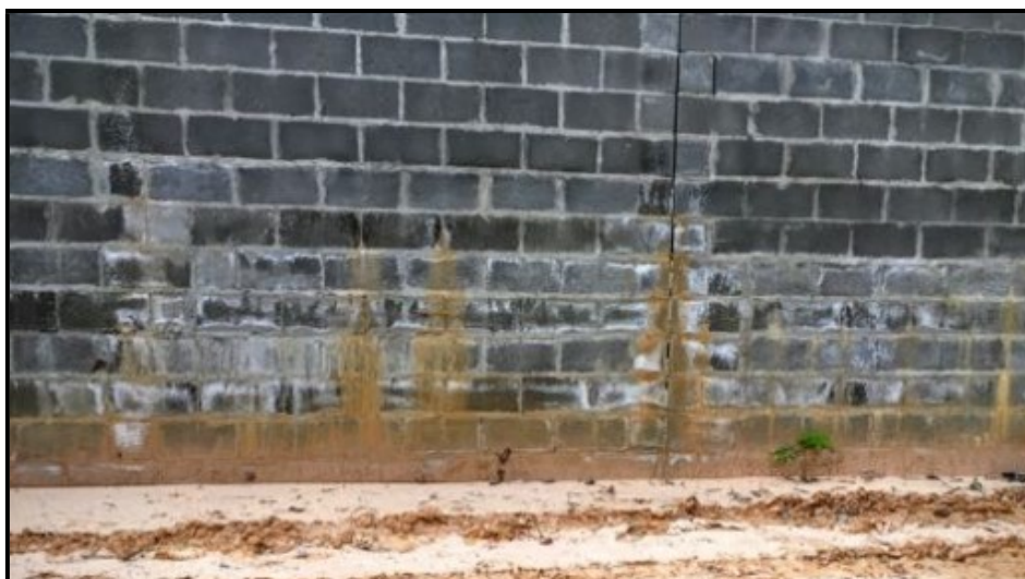
Figura 6 - Eflorescência em parede.
