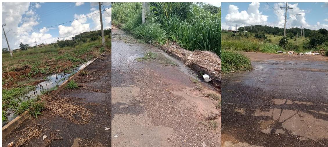
Figura 7: Esgoto a céu aberto
